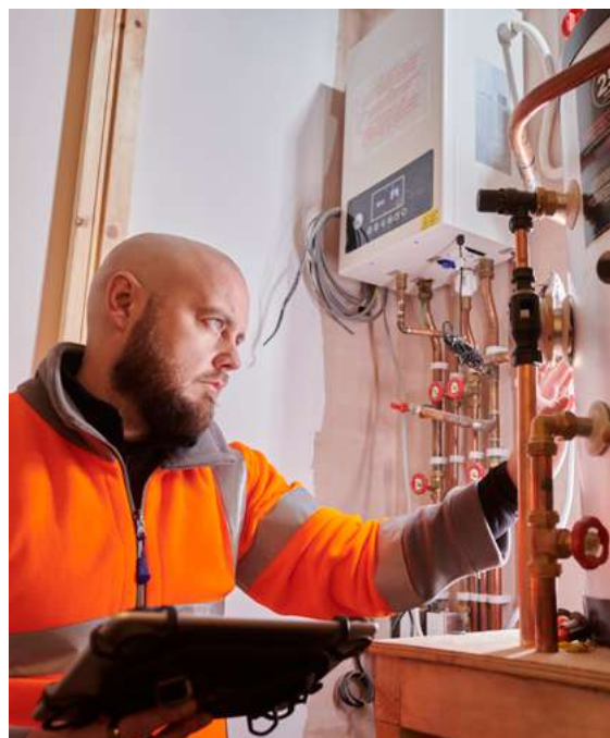
Обслуживание инженерных систем
